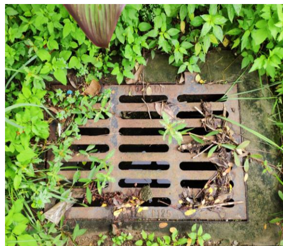
施工生产活区雨水井
