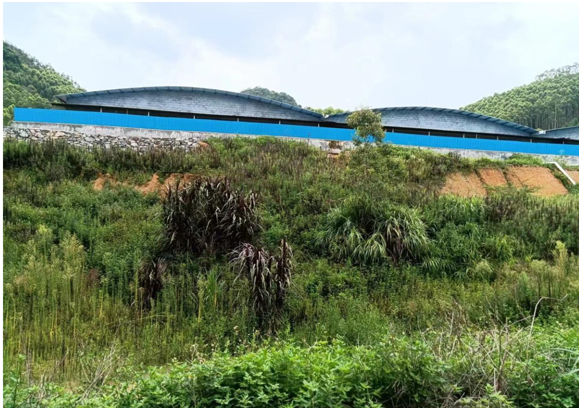
边坡绿化现状（2023.07）
